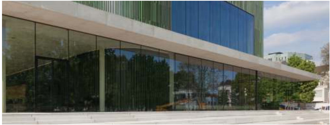
De enorme te openen glaspui bestaat uit twee deuren van 5 bij 8 meter die opgedeeld zijn in 8 glasplaten van 5 bij 2 meter
